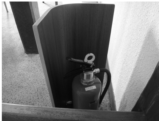
写真6 ザ クラブ2階ロビーの番号付き消火器 (2016年8月23日筆者撮影)
